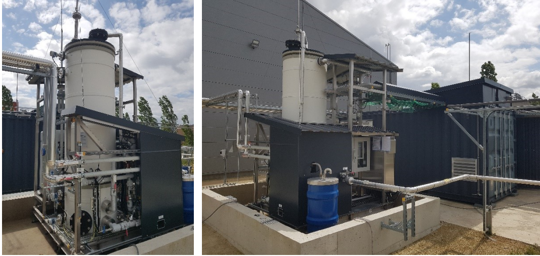
Figure 2 : Réacteur à lit fluidisé GICON® installation pilote Paris
